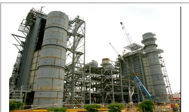
Termoeléctrica Rafael Urdaneta - Ubicada en el estado Zulia, este concepto de producción de energía limpia forma parte del nuevo desarrollo venezolano.
